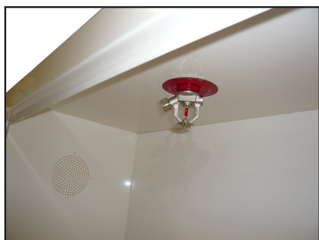
Système d'extinction automatique
